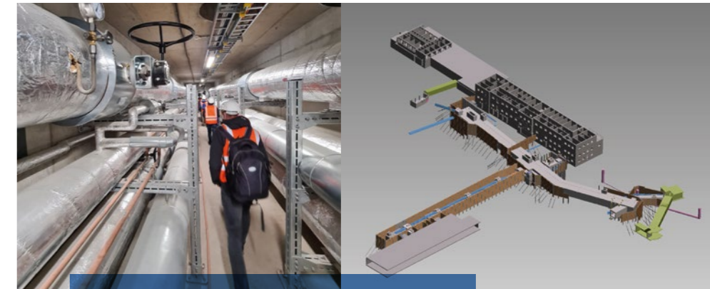
Die Ver- und Entsorgungsleitungen des UKW beeindruckten – in der Realität und in der 3D-Planung.
