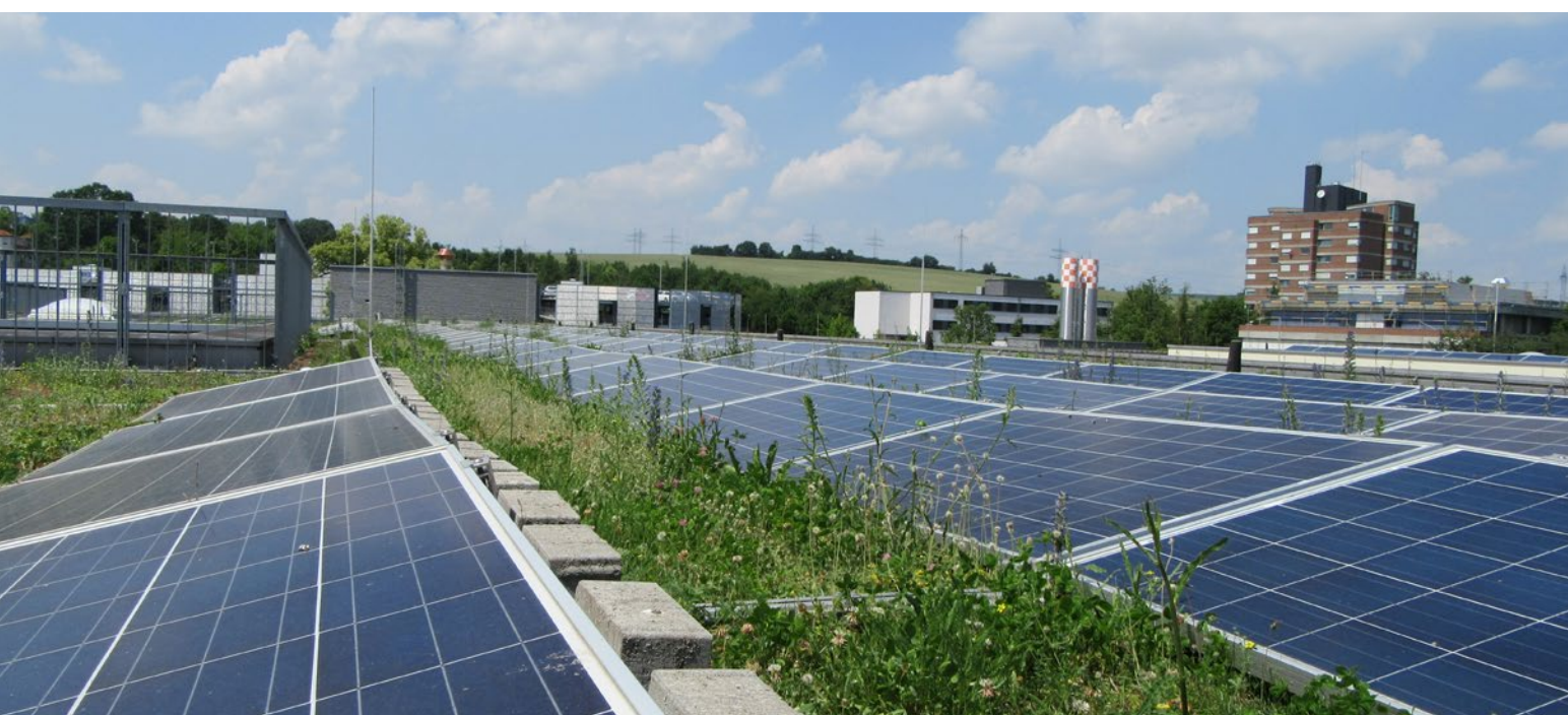
Photovoltaikanlage auf dem Bettenhaus 3 des Zentrums für Innere Medizin
